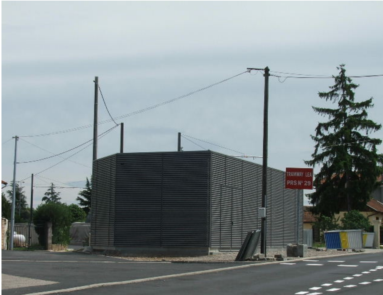
Meyzieu : une sous station d'alimentation électrique aérienne
