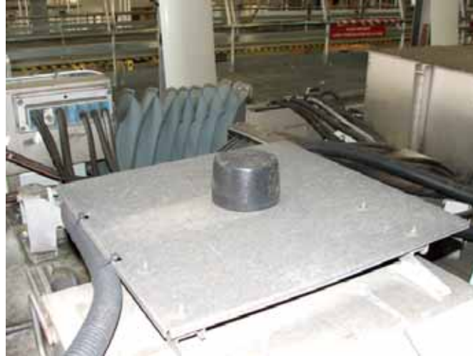
L'antenne du radio-téléphone, pour les communications PCT / Conducteur et les annonces voyageurs.
